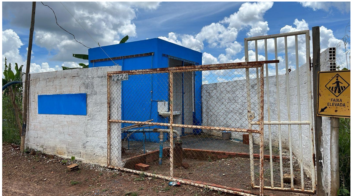
Figura 21: Poço de captação de água Fonte: CODANORTE,2026
